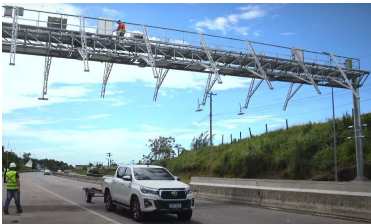
Figura 5: Pórtico com equipamento de cobrança do free flow.
